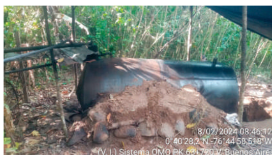
*Registro fotográfico denuncia penal por apoderamiento de hidrocarburos y contaminación ambiental, instalación válvula ilícita sistema de transporte OMO PK63+720.
